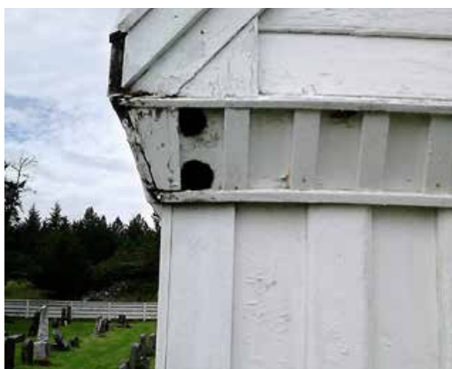
Klokkehuset har mange hull fra hakkespetten.
